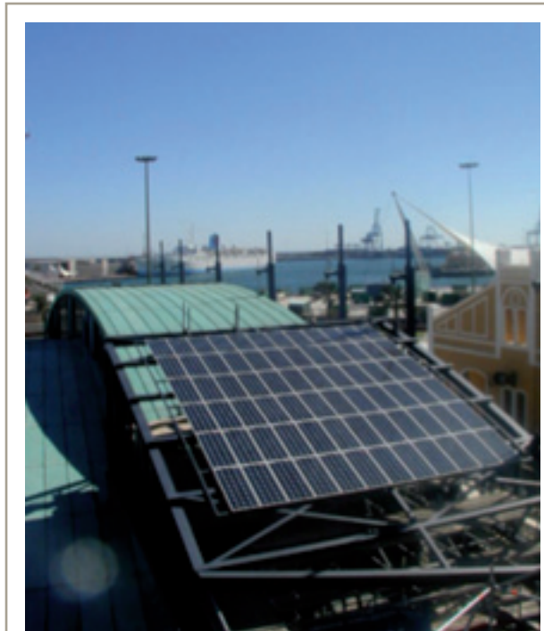
Figura 22.14. Instalación fotovoltaica del Museo Elder de la Ciencia y la Tecnología (Gran Canaria)
