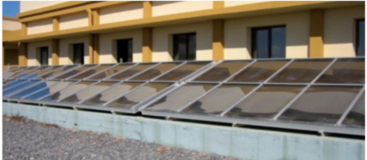
Figura 22.2. Captadores solares de placa plana de gran superficie
