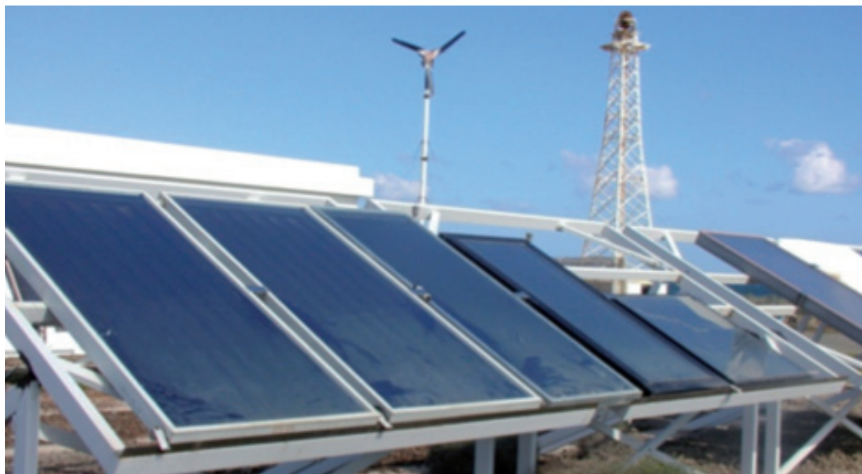
Figura 22.1. Captadores solares de placa plana de distintos tamaños.
